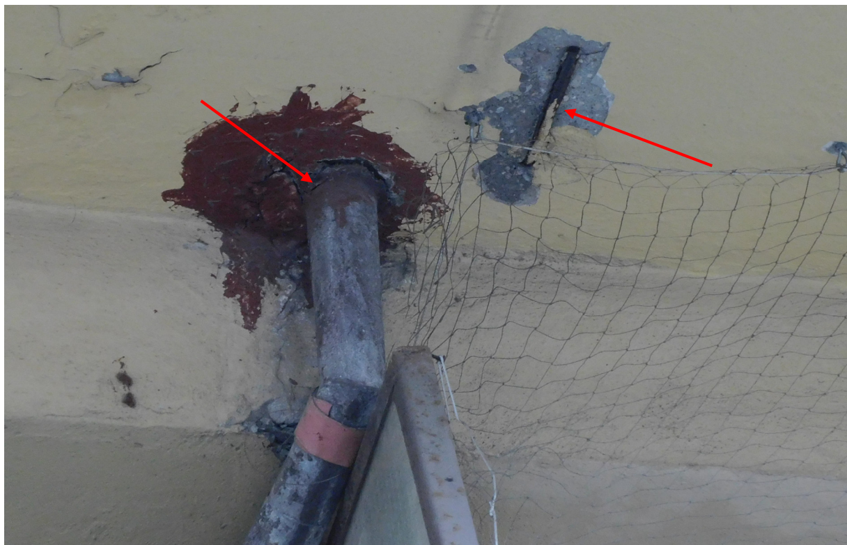
Powyżej przykład destrukcji z powodu nieszczonego systemu odwadniania pow. posadzki balkonów – widoczne odspajanie się otuliny płyty
