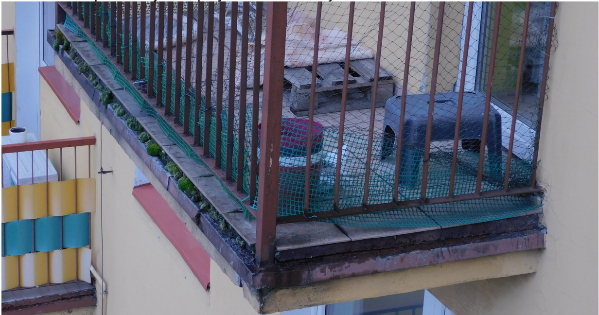
Skutki stałego zawilgocenia i zamakania pasa okapowego -porosty i mchy
