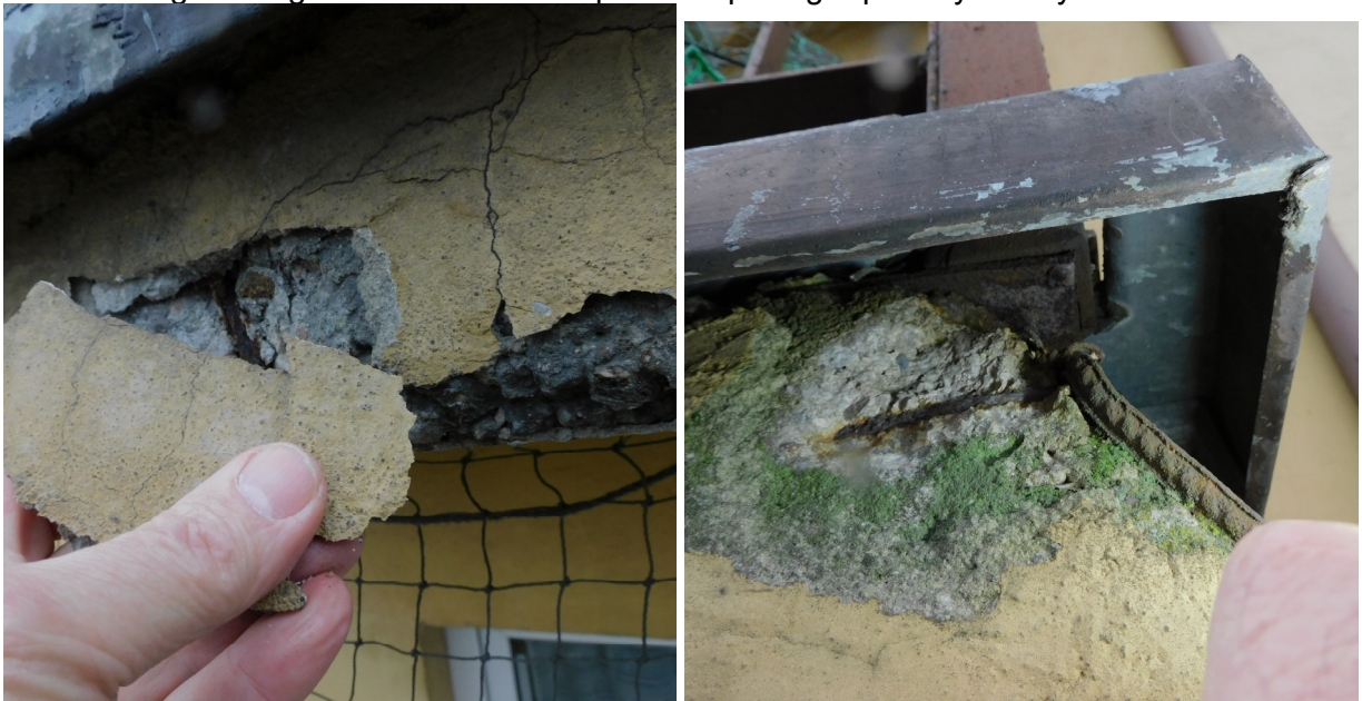
Odpadanie otuliny pod niewielkim naciskiem, widok braku szczelności blachy okapowej w miejscu zamocowania słupka narożnego
