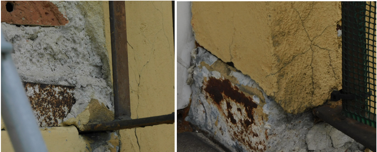
Murszenie i odpadanie tynków przy oknach tarasowych
