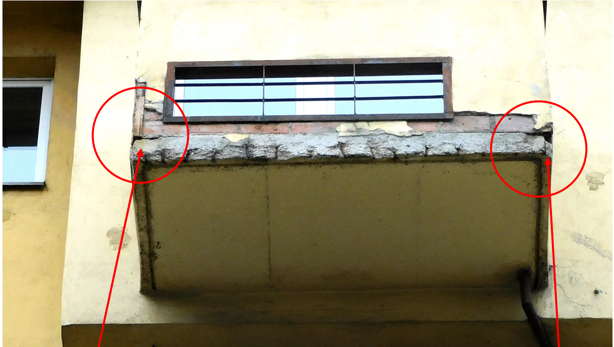
Kolejny przykład analogicznej destrukcji
